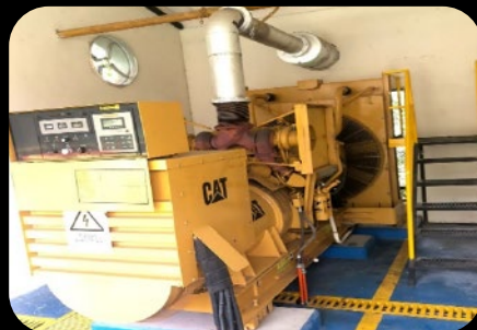
Mantenimiento de motores y generadores (Plantas)
